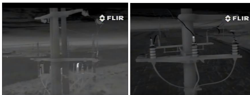
SLIKA 8 Primeri nedozvoljenog zagrevanja na stubu
